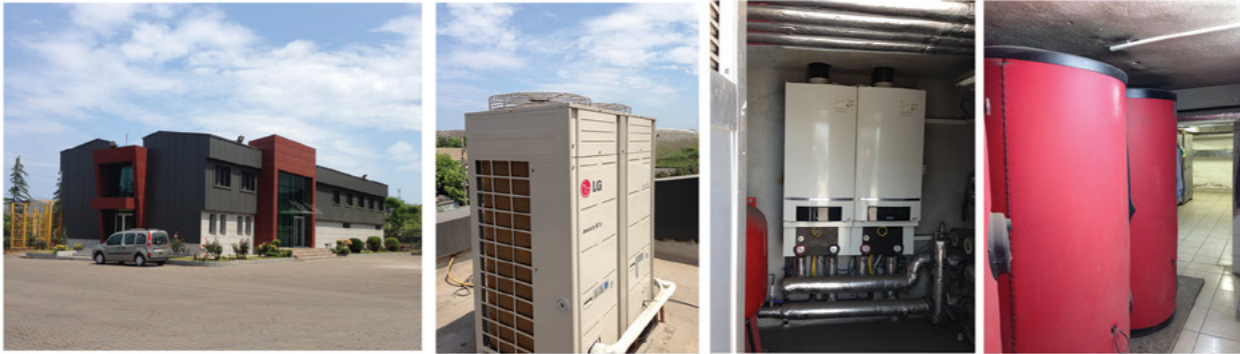
Yeşilyurt İzabe Tesisleri İdari Bina Kalorifer Tesisatı, Pis Su - Temiz Su Tesisatı, VRF Tesisatı, Doğalgaz Tesisatı
