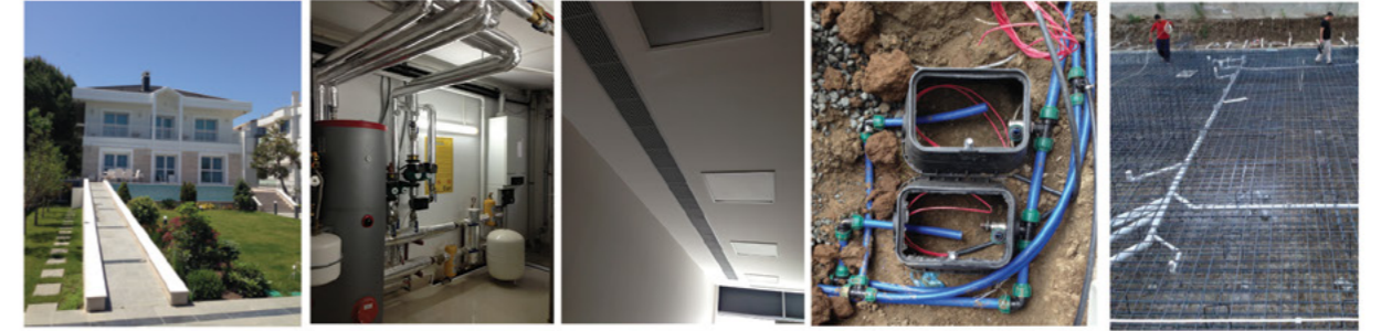
H. Yeşilyurt Villası Kalorifer Tesisatı, Pis Su - Temiz Su Tesisatı VRF Tesisatı, Doğalgaz Tesisatı, Bahçe Sulama Tesisatı
