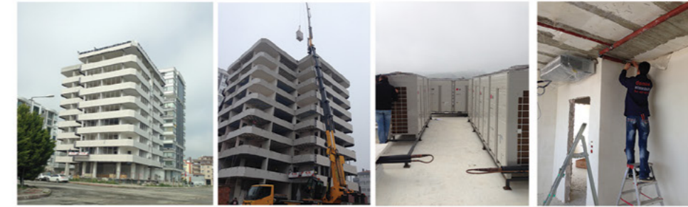
Yavuz Tuna İnşaat Ofis Binası VRF Tesisatı - Yangın Tesisatı
