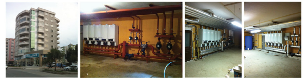
Daştanlar İnşaat Merkezi Sistem Kalorifer ve Boyler Tesisatı
