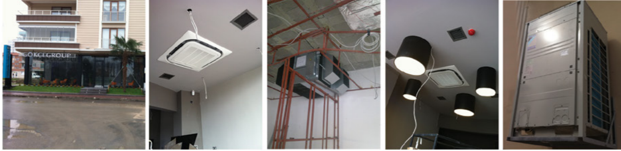
Gökçe Group Kalorifer Tesisatı, VRF Tesisatı, Havalandırma Tesisatı ve Sıhhi Tesisat
