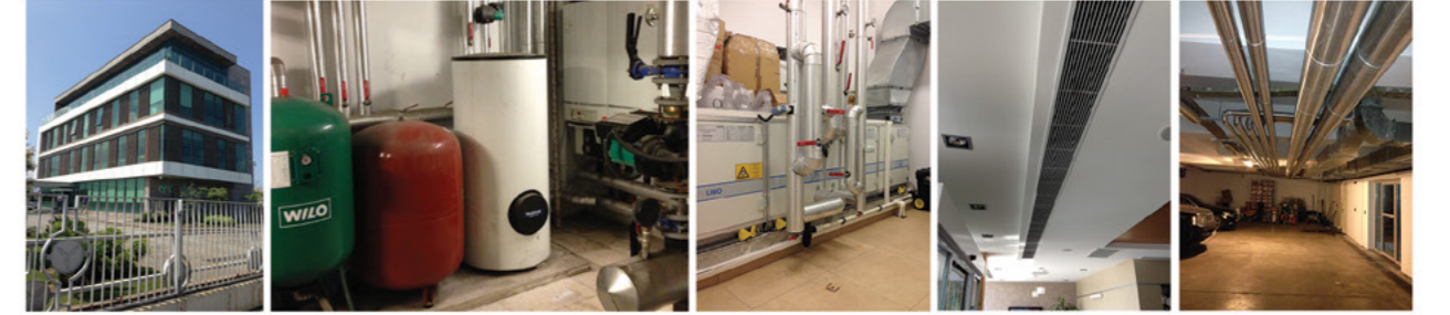
Samsun Yeşilyurt İdari Bina Fan-Coil, Klima, Havalandırma, Pis Su-Temiz Su, Yangın Tesisatları
