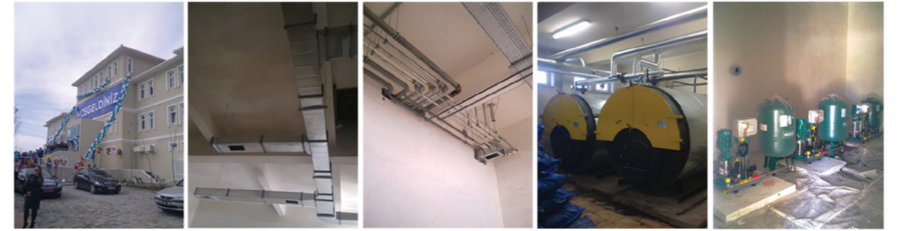
Ridvan Çelikel Öğrenci Yurdu (KAVAK) Kalorifer Tesisatı, Pis Su - Temiz Su Tesisatı, Klima - Havalandırma Tesisatı
