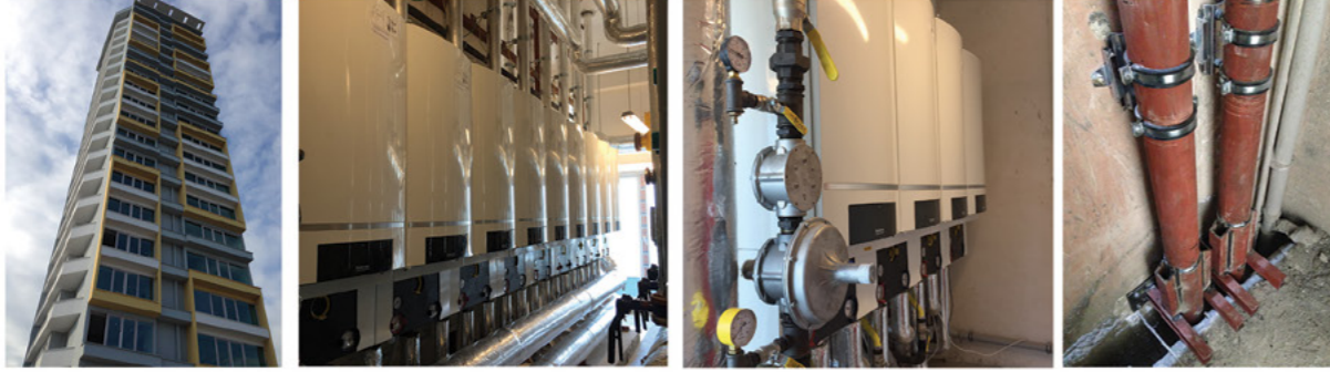
Samtower Kalorifer Tesisatı, Pis Su - Temiz Su Tesisatı, Yangın Tesisatı
