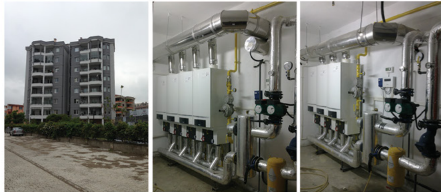
Tutkun Sitesi A B C Blok Merkezi Sistem Kaskad Uygulamaları ve Doğalgaz Tesisatları
